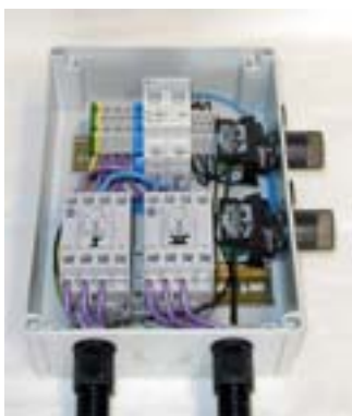
Bilde viser kontaktorskap for 14 kW
