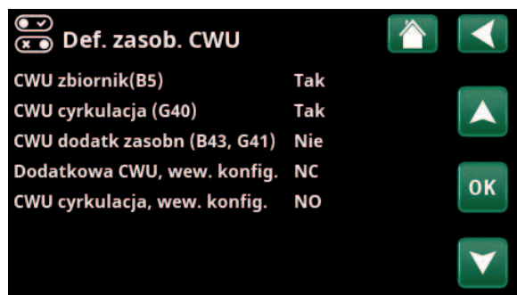
Menu: „Instalator\Definiuj\Zbiornika CWU”.
